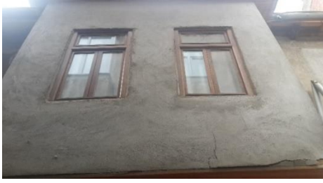
Fot. 14. Konağın batı cephesinde görülen çatlaklar (Çalın, 2015).
