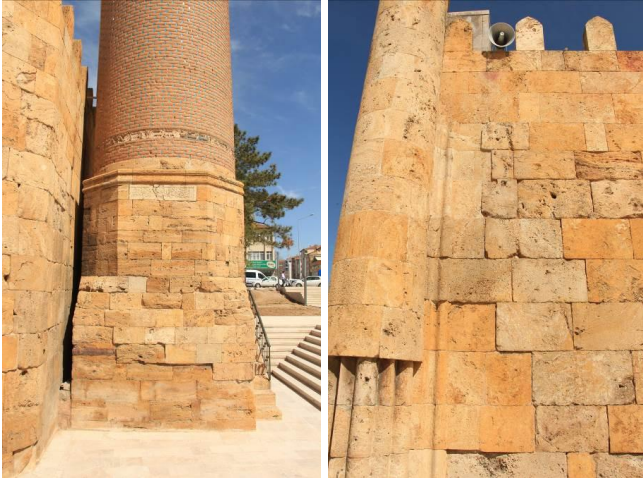
Fot. 3. Medrese Güney(arka) cephesinde yer alan minarenin taş kaidesi ve Batı Cephesinde yapılan onarımlar ve izleri; 1960 restorasyonu sonrası kullanılan yeni taş ile yapının özgün taşları arasındaki renk ve yüzeyel fark (Ocak, 2015)
