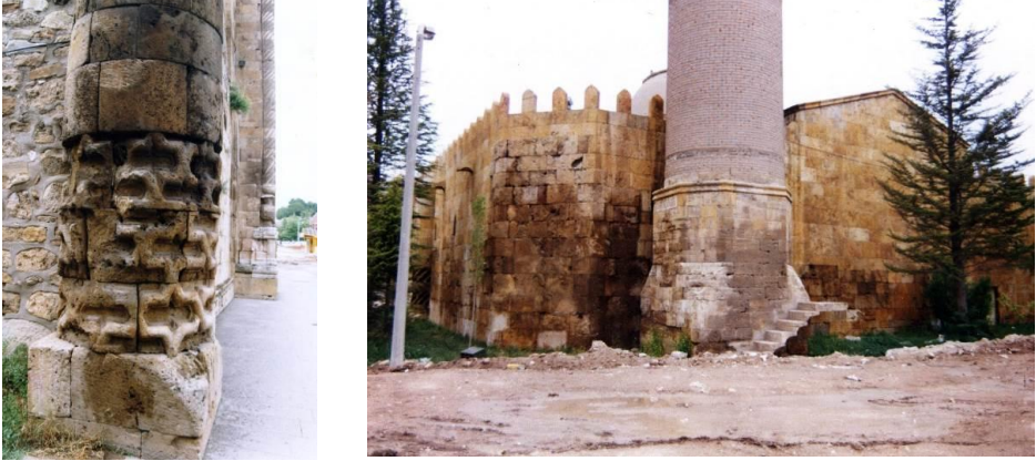
Fot. 13. Vakıflar Arşivi'nde bulunan Medresenin 1996 tarihli fotoğrafları; Güney cephesi ve Doğu köşe payandasında yükselmiş nem problemleri söz konusudur.
