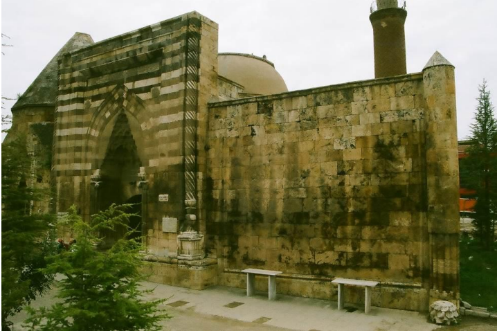
Fot. 12. Vakıflar Arşivi'nde bulunan Medresenin 1996 tarihli fotoğraflarda medresenin ciddi su yalıtım problemleri yaşadığı görülmektedir.
