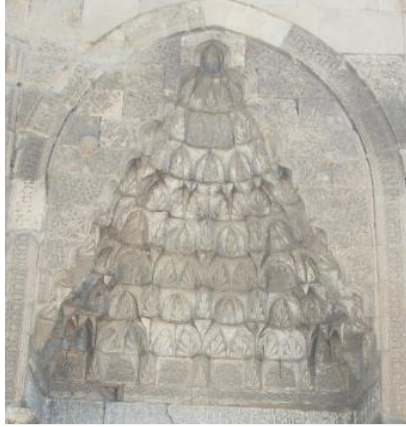
Fot. 5. Amasya Şifahanesi taş kapısındaki kuşatma kemeri ve iç bölümdeki deformasyonlar.
