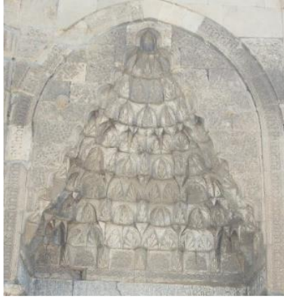
Fot. 5. Amasya Şifahanesi taç kapısındaki kuşatma kemeri ve iç bölümdeki deformasyonlar.
